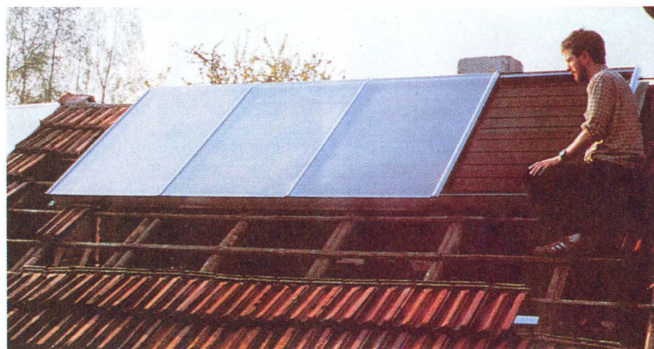
Закрепив на крыше корпус коллектора и проложив трубопроводы контура циркуляции теплоносителя, приступают к установке стёкол.
